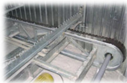
Auto-rateau de stockage de glace- Structure 2
