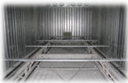
Auto-rateau de stockage de glace- Structure 1
