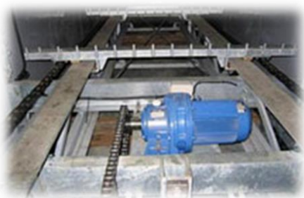
Auto-rateau de stockage de glace- Structure 2
